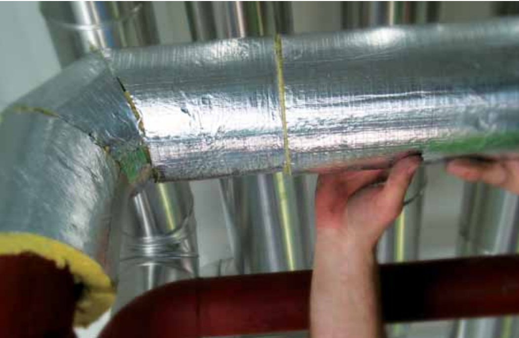
Izolační skruž na potrubí
